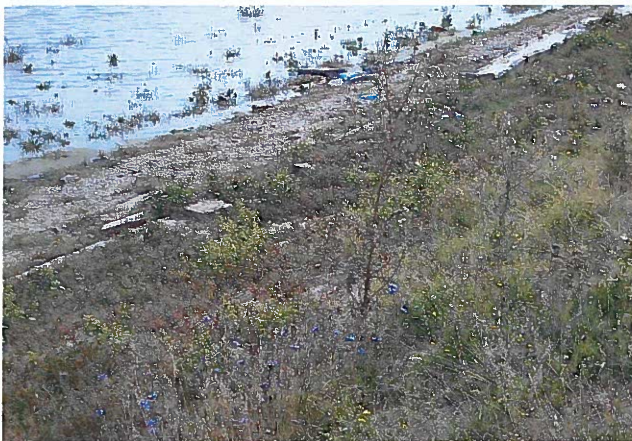
Figură 3 Taluz amonte - pereu deteriorat
