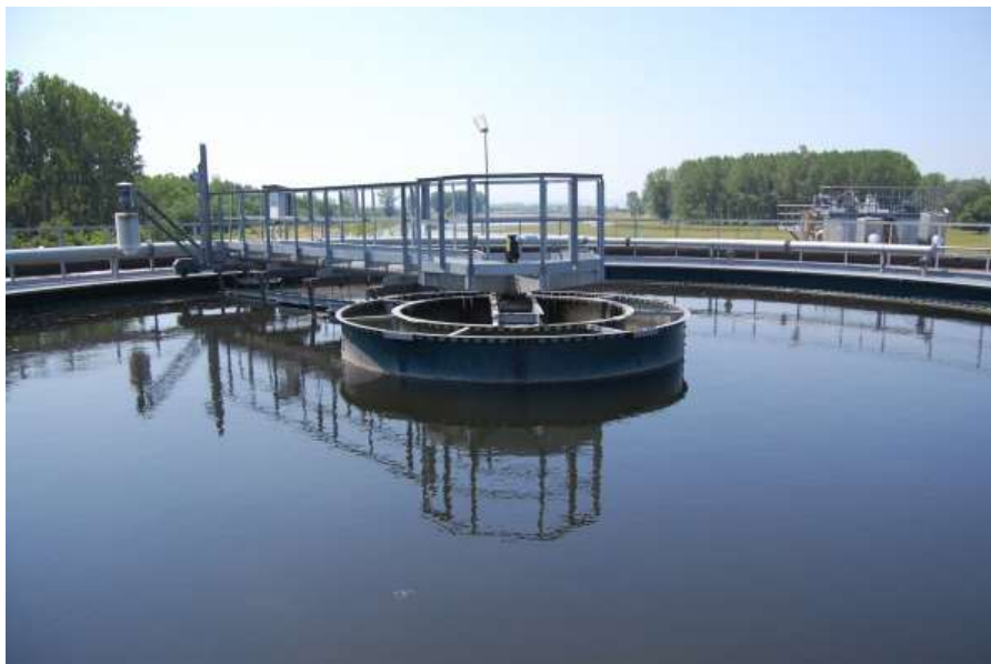
Stația de epurare Făcăi (Craiova) 10
